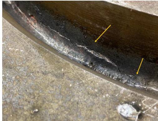
Gambar 2. Retakan Yang Terjadi Pada Back Gouging
