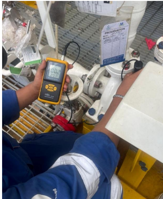
Gambar 4. 4 Dokumentasi Pengukuran Vibrasi Pump (Sumber: Dokumentasi John Perry Pandiangan, 2025)
