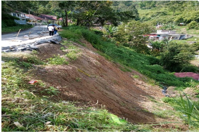
Gambar 2. Kondisi Lereng Eksisting
