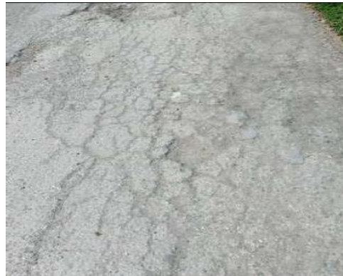
Gambar 3. Bentuk Kerusakan Retak kulit buaya
