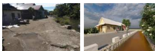
Gambar 2. Kondisi Jalan Lingkungan Yang Belum Dilakukan Penanganan
