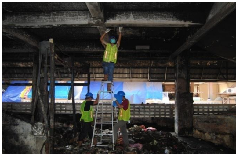
Gambar 3. Kondisi gedung pasca bakar dan pengecekan kondisi struktur di lapangan
